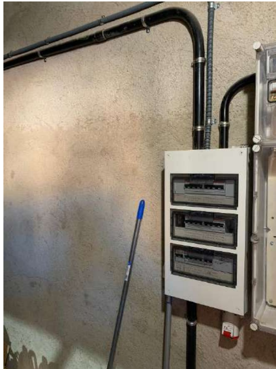
Il·lustració 3 Ubicació inversor fotovoltaic
