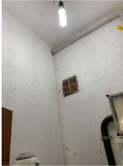
Il·lustració 11 Ubicació inversor fotovoltaic
